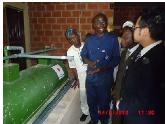
施設内に設置された加工機材
